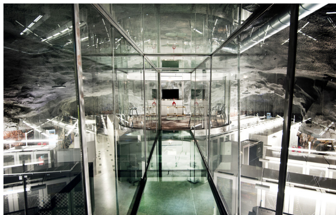
Рис 1.1 Підземний дата-центр Pionen Data Center Стокгольм, Швеція
